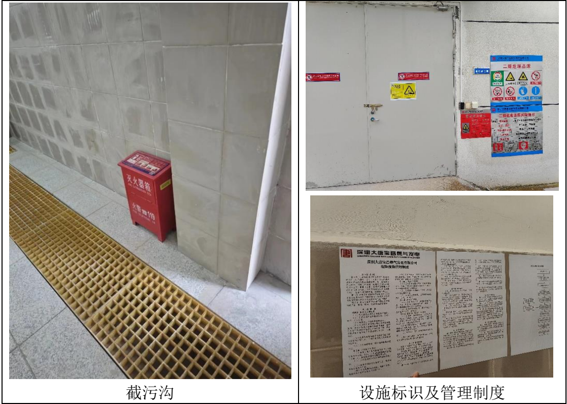
图 4.4-1 危险废物暂存间实景照片
