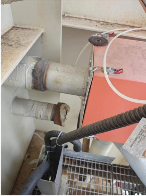
图 9.1 脱硝前采样口情况
