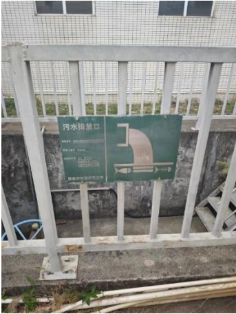
污水排放口标识
