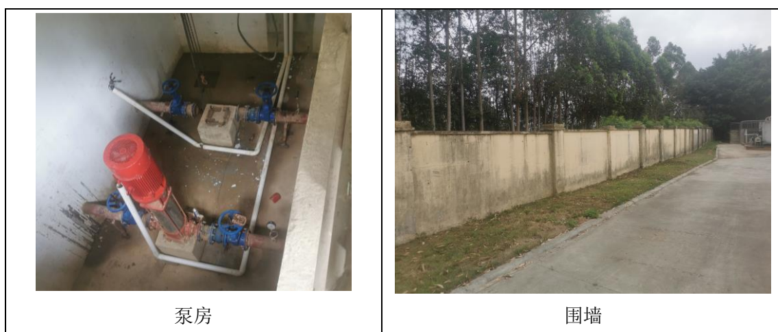
图 4.3-1 噪声污染防治措施现状图片
