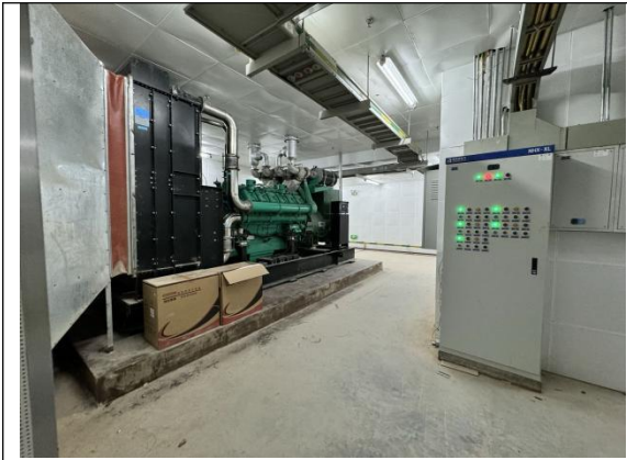
备用发电机房减震基座
