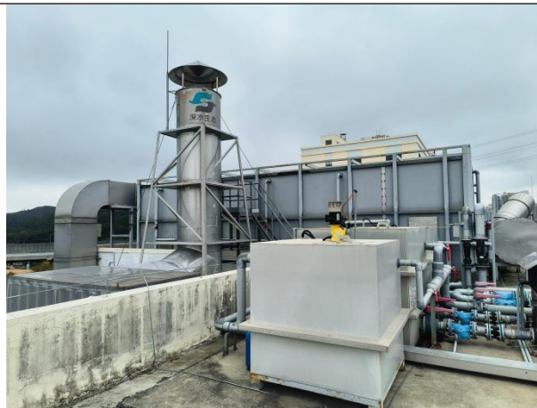
依托的通沟污泥站废气处理设施排放口 DA003
