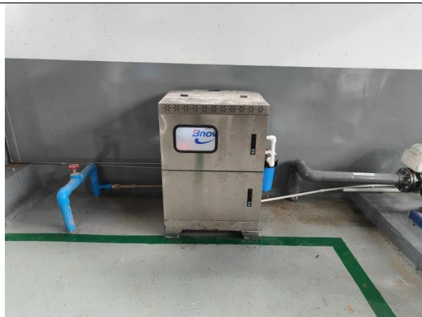
除臭喷雾控制柜
