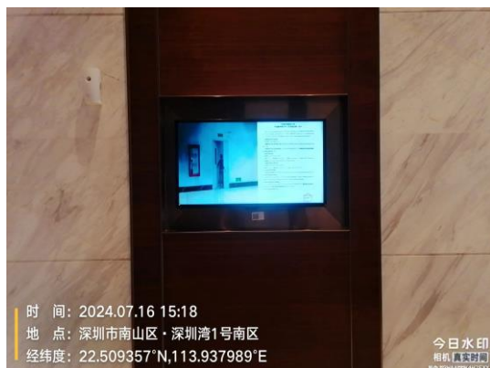
深圳湾1号南区电梯厅电子屏
