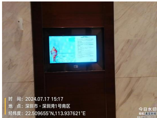
深圳湾1号南区电梯厅电子屏
