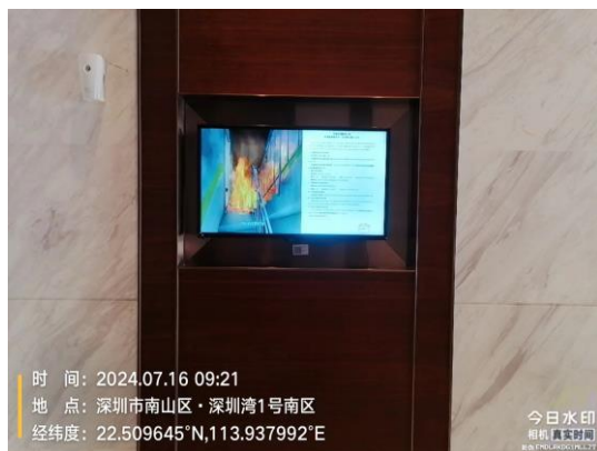
深圳湾1号南区电梯厅电子屏
