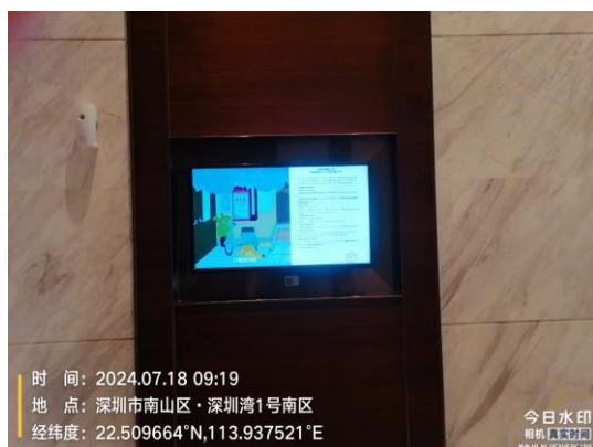
深圳湾1号南区电梯厅电子屏
